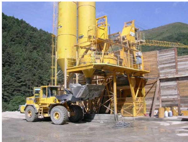
Planta de Hormigón con mezcladora
