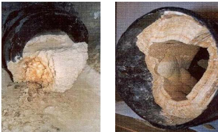
Detalle de drenajes de túnel obturados
