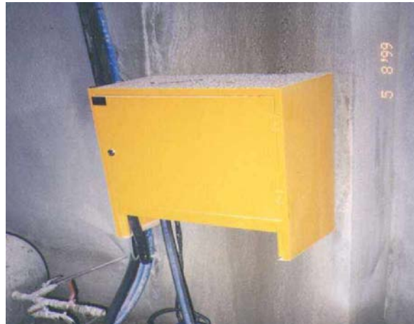
Equipo dosificador de aditivos en planta
