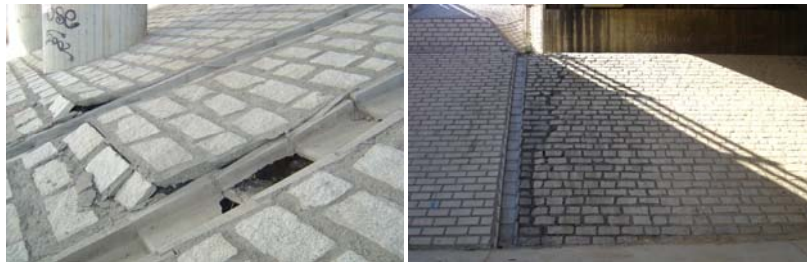
Figura 10. Estado del encachado de protección de un terraplén de viaducto.
