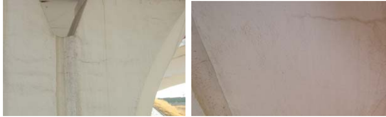
Figura 11. Fisuras horizontales o verticales en pilas, pero debidas a asentamiento plástico.
