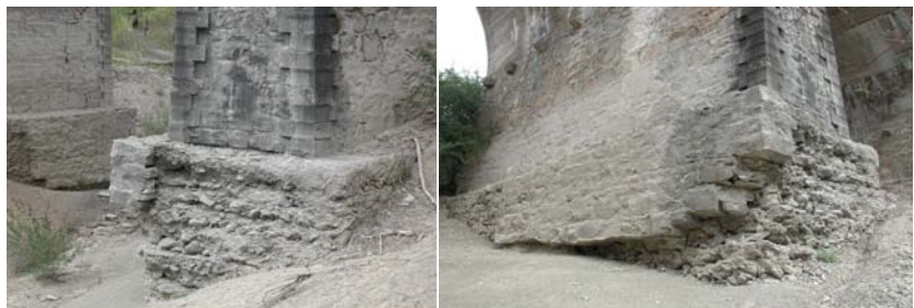
Figura 8. Deterioro de la cimentación de un puente sobre un embalse, detectado a finales del verano, con el embalse en cotas bajas.
