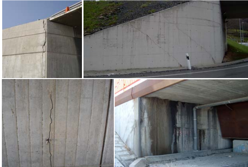
Figura 9. Algunos daños típicos en muros y estribos.
