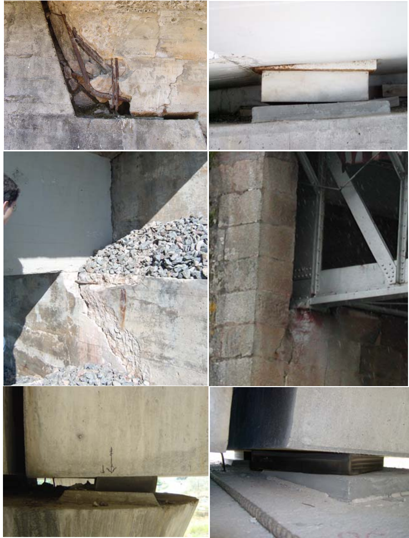
Figura 22. Ejemplo de daños en aparatos de apoyo y zonas aledañas.
