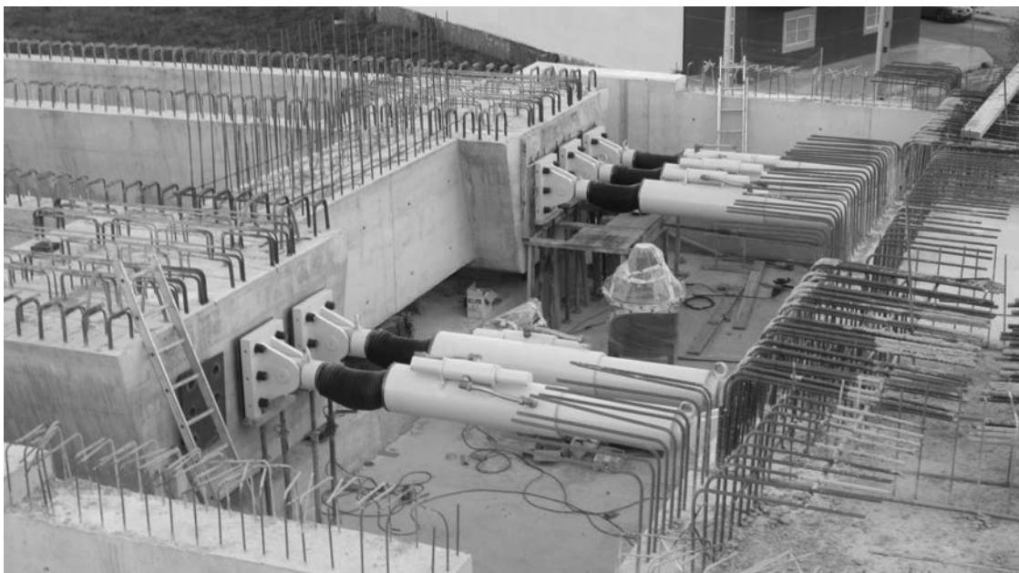
Figura 10. Fotografía detalle dispositivos antisísmicos en Viaducto Callosa-Cox.
