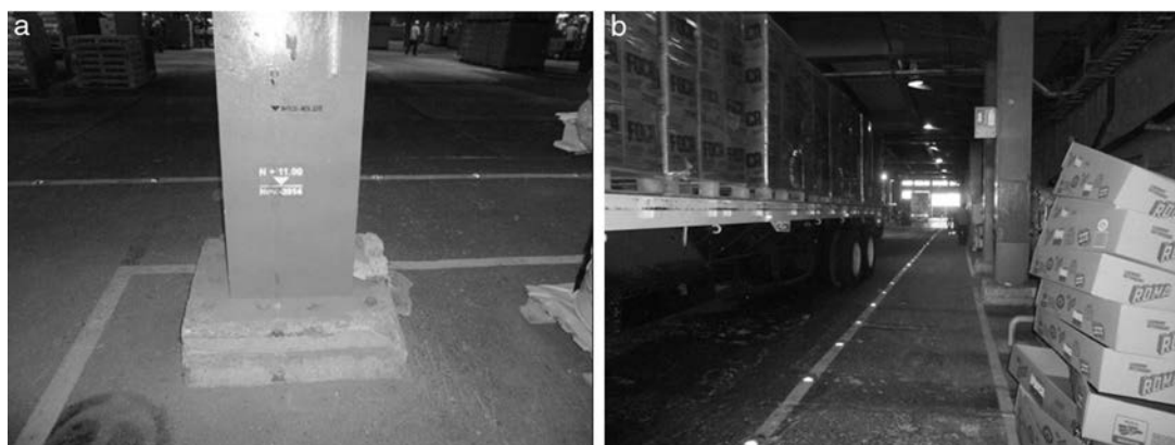
Figura 4. Desnivel en pasillo central (véase los dados de las columnas).
