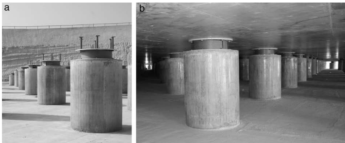
Figura 9. Aisladores sísmicos sobre pedestales de hormigón, antes y después del hormigonado de la losa superior.
