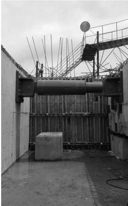
Figura 13. Vista de uno de los amortiguadores longitudinales del estribo 1.
