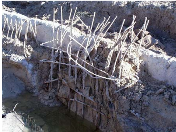
HORMIGONADO DEFECTUOSO DE UN PANEL DE PANTALLA
