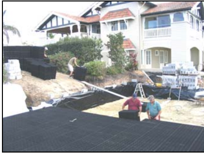
Figura 11. Depósito de detención enterrado.
