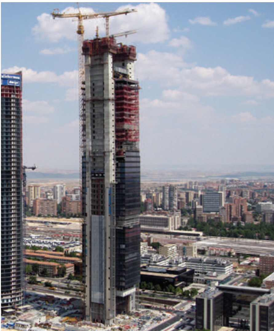
Figura 1. Vista del edificio antes de la elevación de la estructura del puente de coronación (cortesía de Vistaarea)
