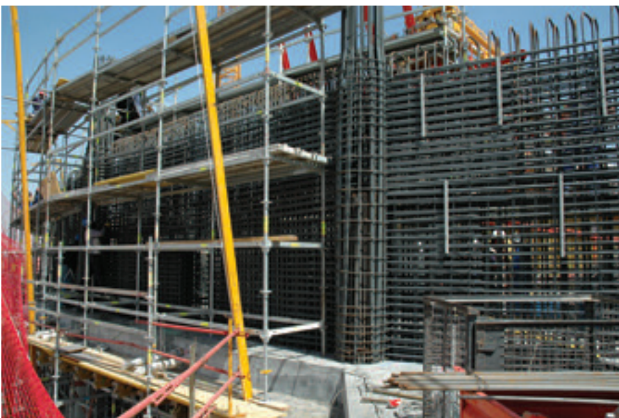
Figura 12. Ferrallado de las pantallas perimetrales del cinturón de rigidez conectadas con los soportes de la fachada.
