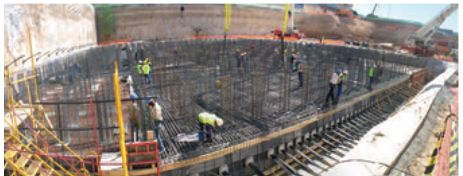
Figura 4. Imagen general de la losa de cimentación con los grupos de armadura de cortante y los anclajes de pretensado.
