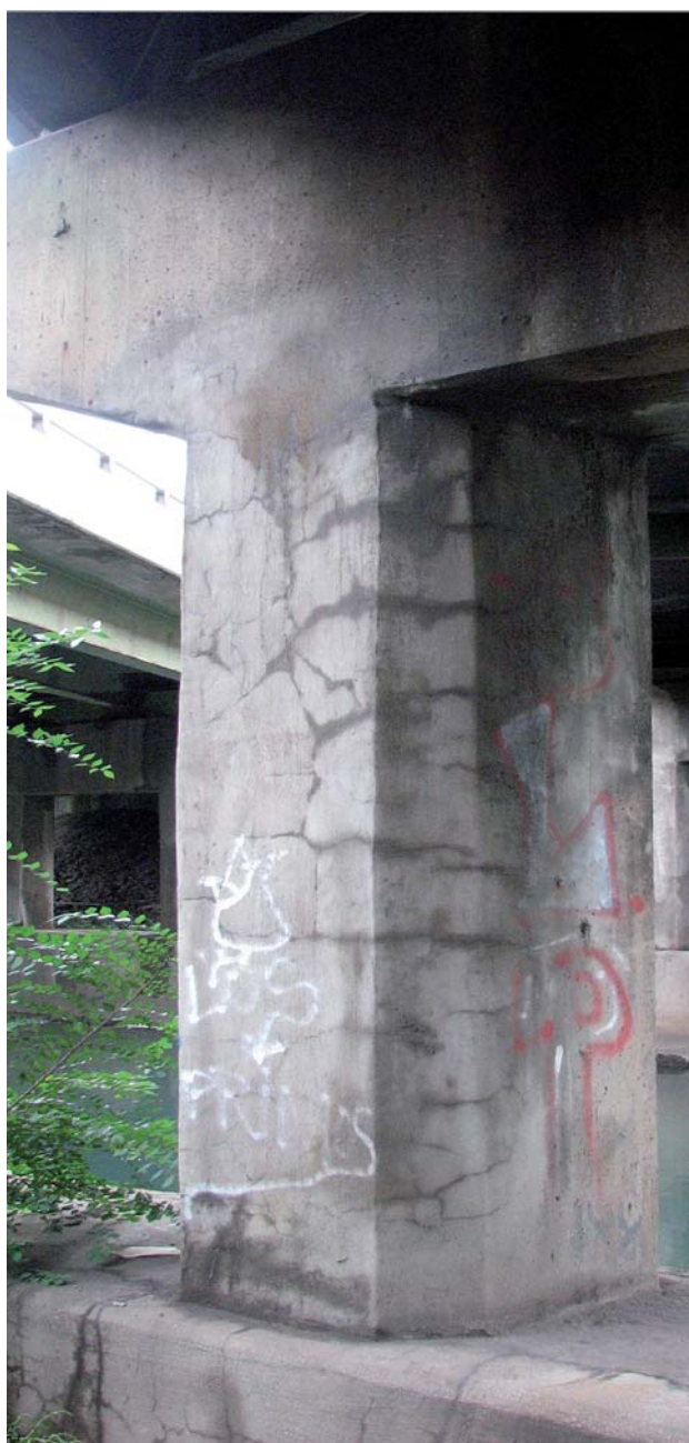
⇒ Figura 10.- Pila de puente afectada de patología.
