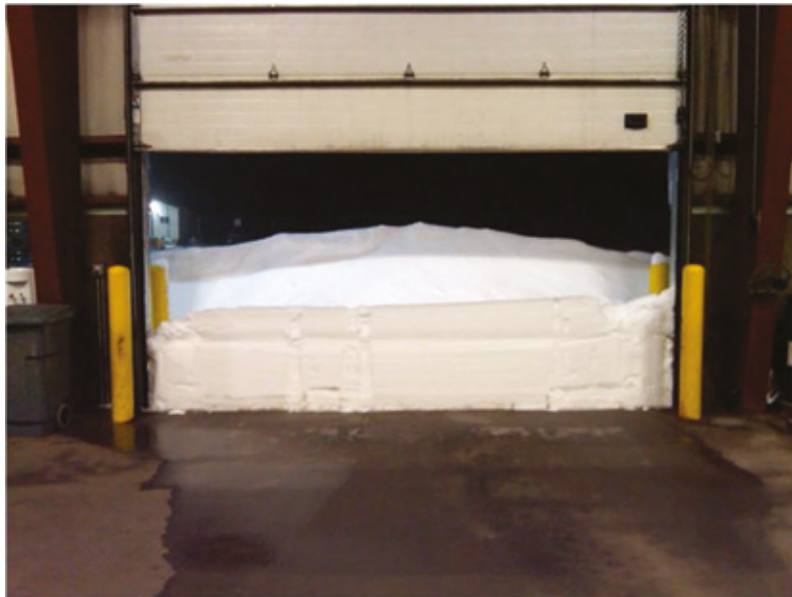
Ilustración 2: Acumulación de nieve en el punto de acceso de una instalación en el condado de McHenry
