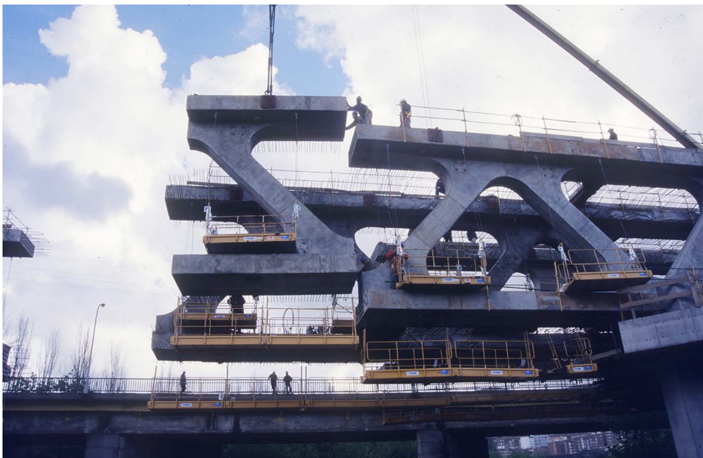
Construcción del doble puente ferroviario de Etxebarri sobre el río Nervión. Bilbao, España 2005.
